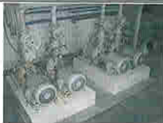
Pumpen im Wasserwerk
