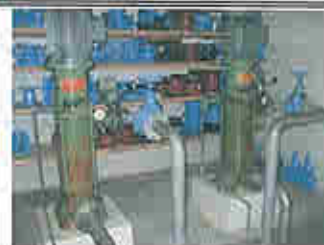
Pumpen im Wasserwerk
